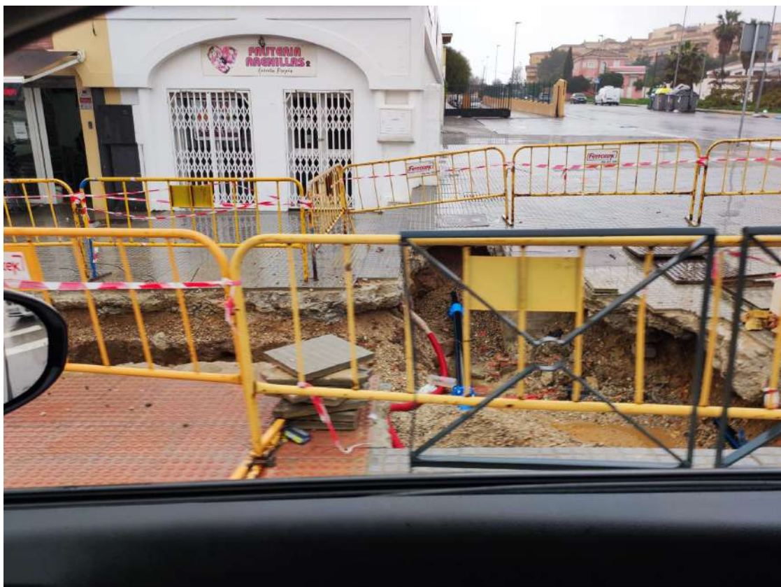
Un corte de agua afecta a varias zonas de San García y calles colindantes. Foto de una de las incidencias detectadas, en Rinconcillo.
